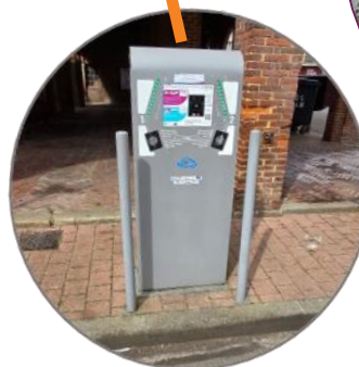
Borne de recharge pour véhicules électriques
